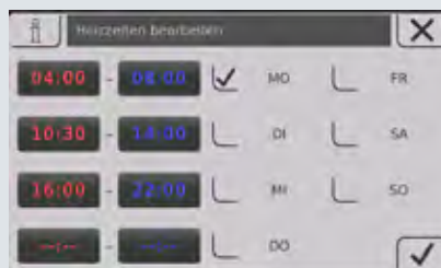
Abb. 2 Ansicht der Heizzeiten (individuell einstellbar)
